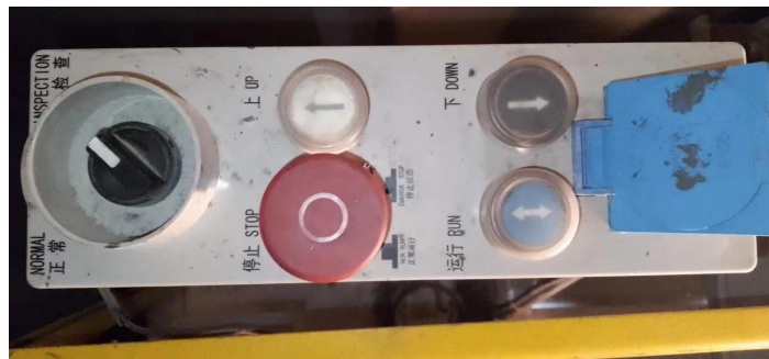
图 B.3 轿顶检修开关、急停开关
