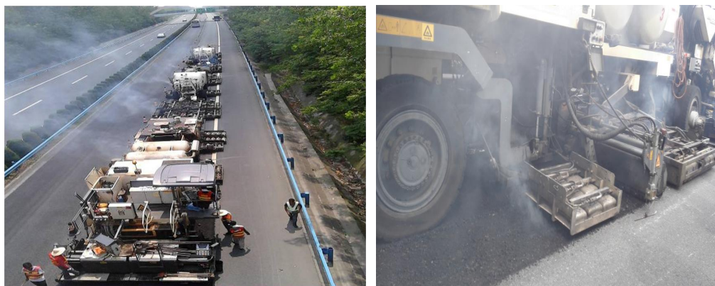
图 2 热再生大型机组施工现场烟尘
